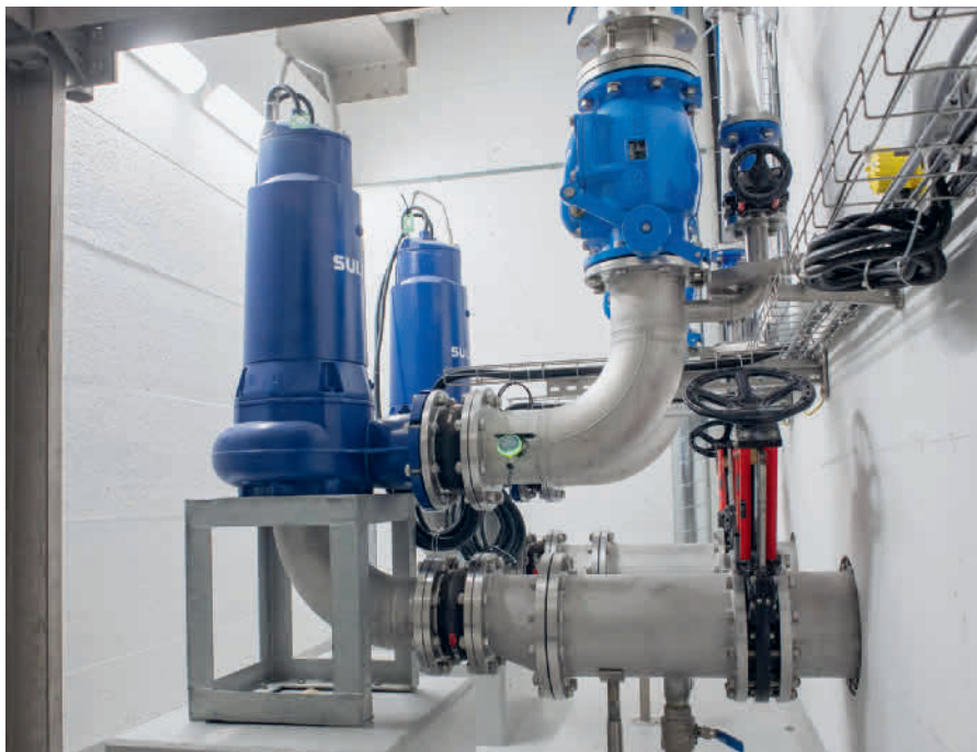
Das «Herz» des Pumpwerks
