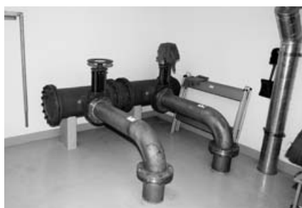
Die zwei Pumprohre
