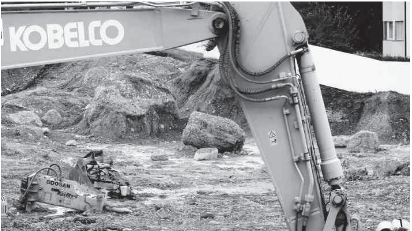
Die Findlinge in der Baugrube Mülimatt - da müssen die grossen Maschinen ran.
