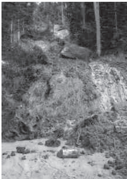
Eine abgerutschte Böschung, mit starker Beschädigung der talseitigen Mauer
